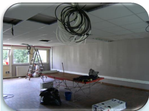
Locaux du CSU 105 600 Euros
